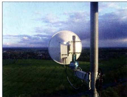
Der 65er-Spiegel Richtung Südosten, 60 m ü. Grund, gut auf dem Gehäuse zu erkennen: die GPS-Antenne für den OXCO. Foto: DK2ZF
