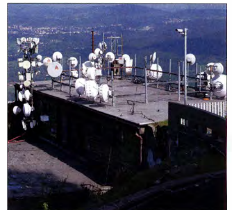
Wegen seines hohen Standorts nutzen zudem viele Funkdienste der Region den Jeschken. Mehr als 50 Richtantennen sind dort montiert. Fotos: DG1VR
